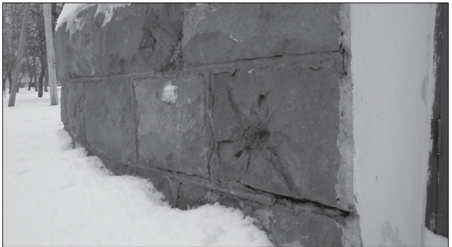
Цокольна частина водонапірної вежі, що знаходиться у центрі міста, зі слідами обстрілу з авіаційного крупнокаліберного кулемета
