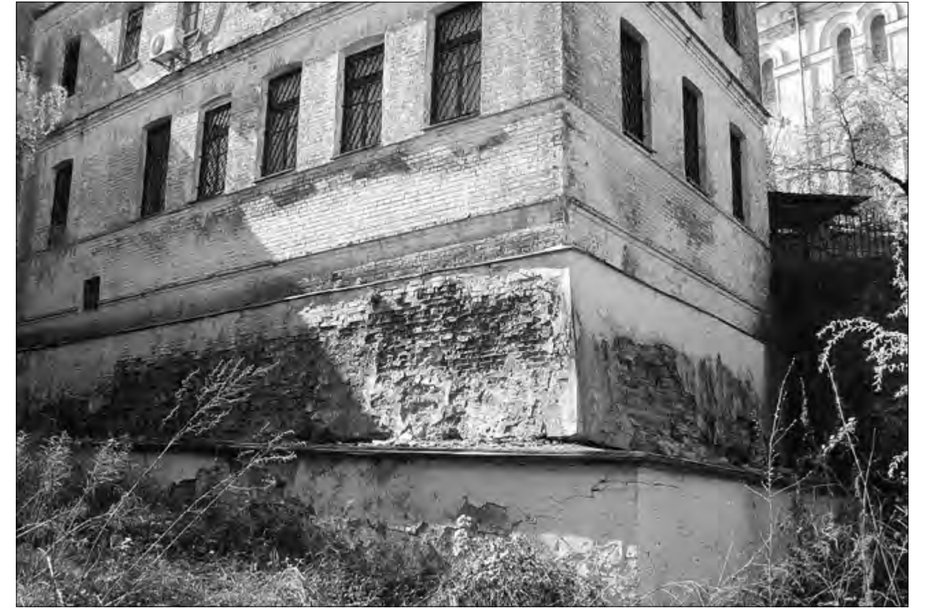
Рис. 3. Фрагмент південного та східного фасадів корпусу № 31. Прогресуюча деструкція лицевої поверхні цегляного мурування у цокольної частині (вперше зафіксовано у березні 2019 р.)
