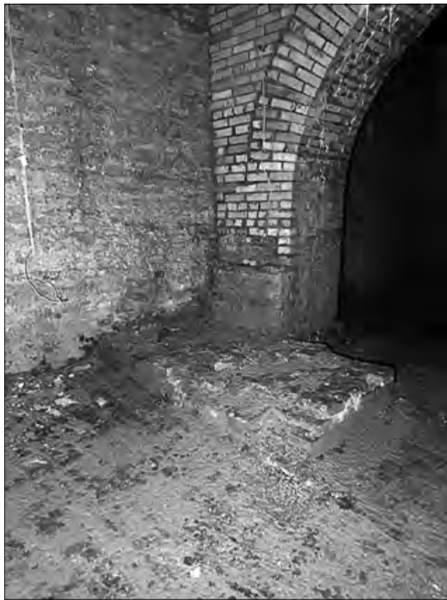
Іл. 3. Залишки зворотного контрфорсу підпірної стіни Верхньої лаври в інтер'єрах підземної споруди № 10
