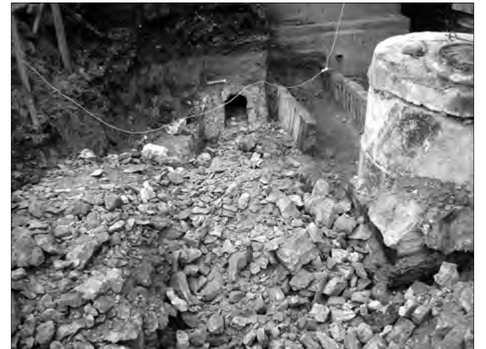
Іл. 4. Дренажна водовідвідна галерея XIX ст., зруйнована під час земляних робіт
